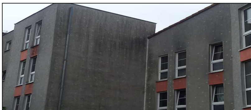
Dämmfassade, Beschädigt durch Umwelteinflüsse, Vogelschäden etc.
